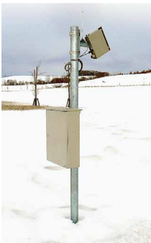
現地設置状況
